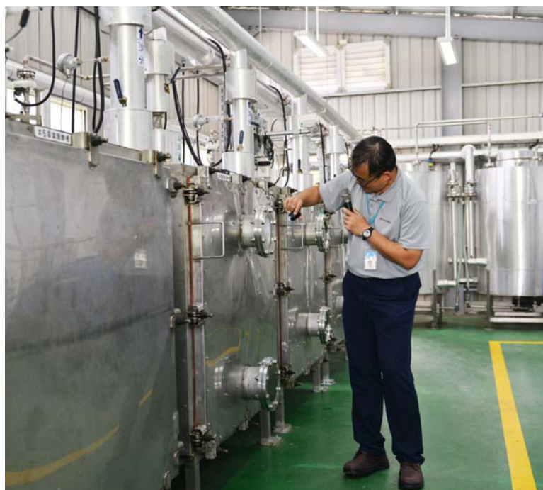
在「乾式厭氧醱酵技術」綠能驗證示範場域，現場聞不到腐臭味，更像是高科技業的生產線工廠。
